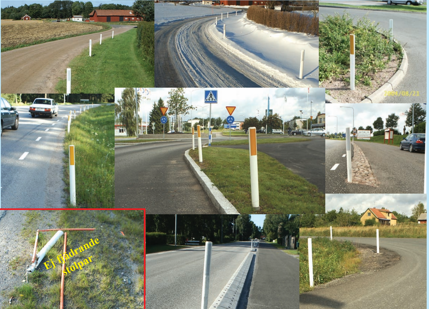
Kantstolpar av ej fjädrande fabrikat
